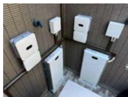
蓄電システム【15kWh×2組】
