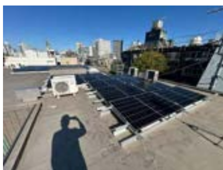
太陽光発電パネル【陸屋根面】
