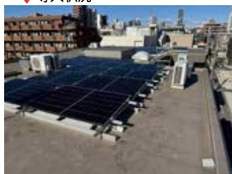
太陽光発電パネル【陸屋根面】
